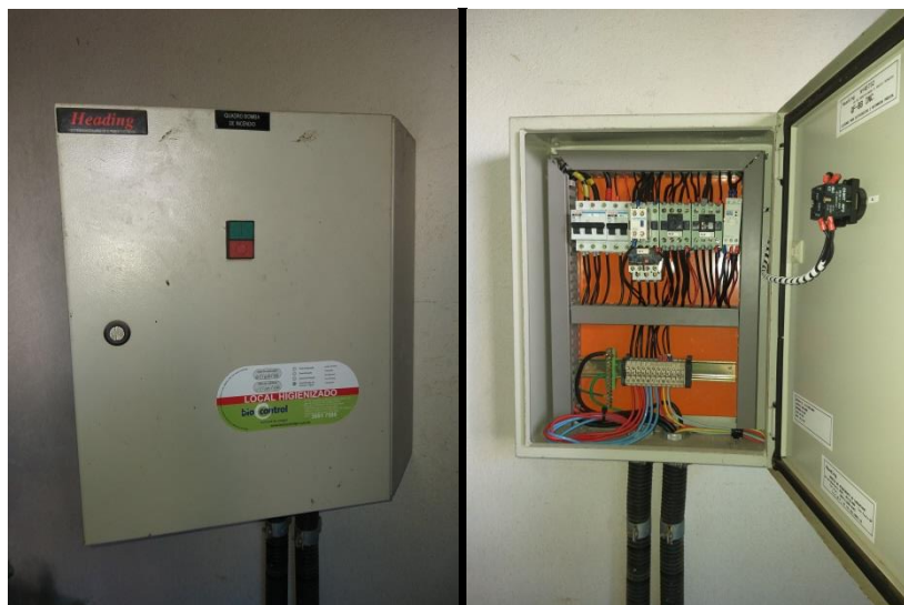
QD bomba de incêndio
